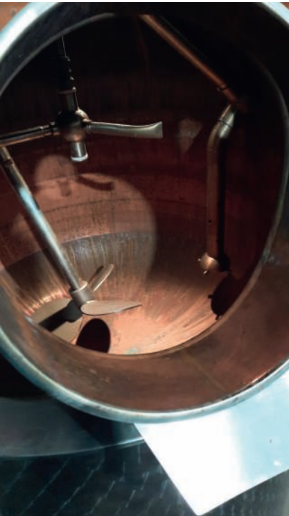
Foto von © I-f-GE e.V. Rührwerk im Kessel
